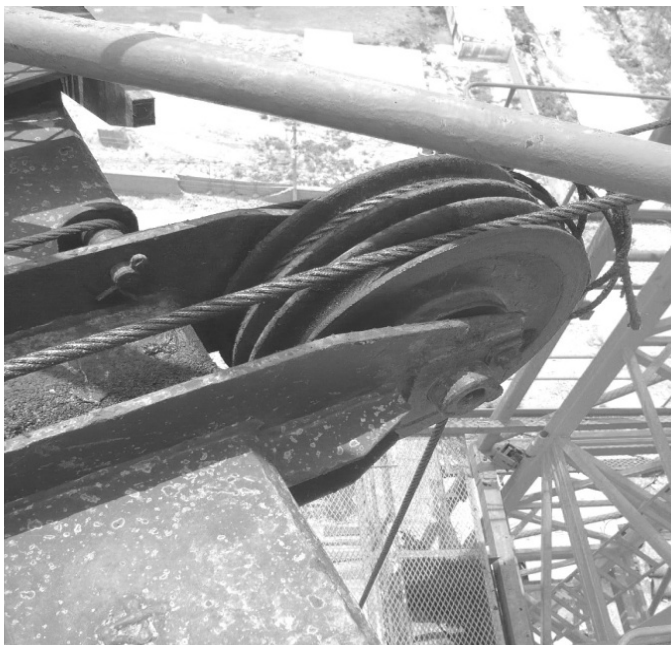
图4.1-4 起升滑轮组无防脱装置
