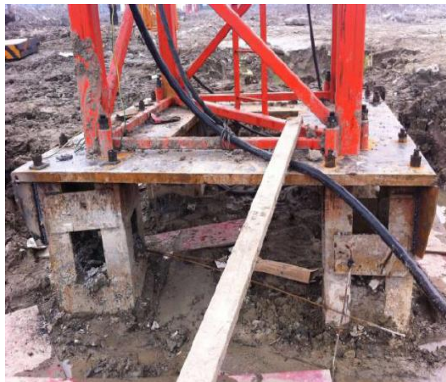
连接处的结构刚度严重突变
