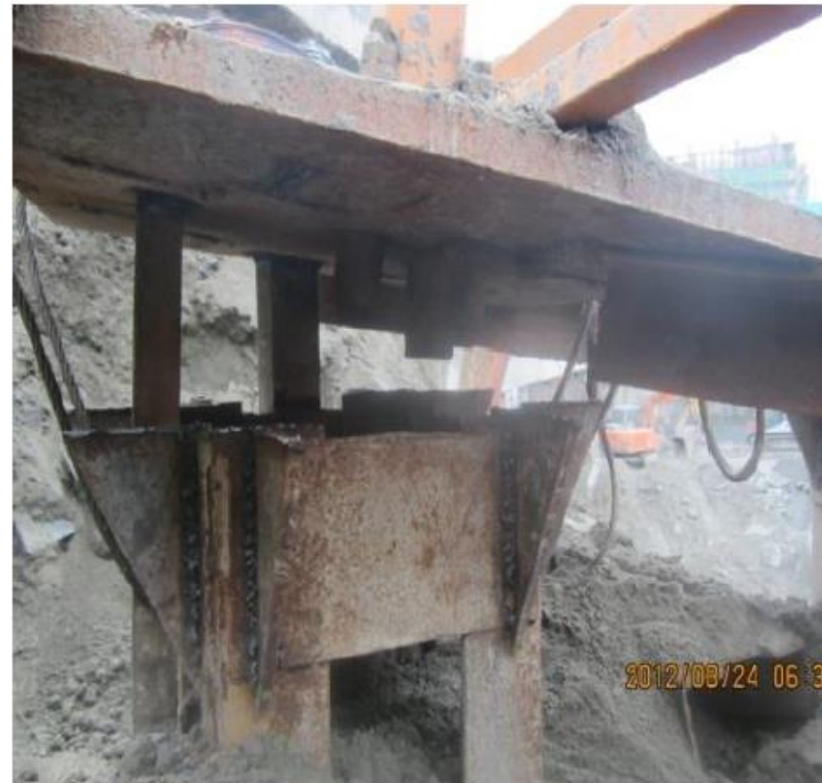
全部仰焊缝几乎全部为虚焊案例
